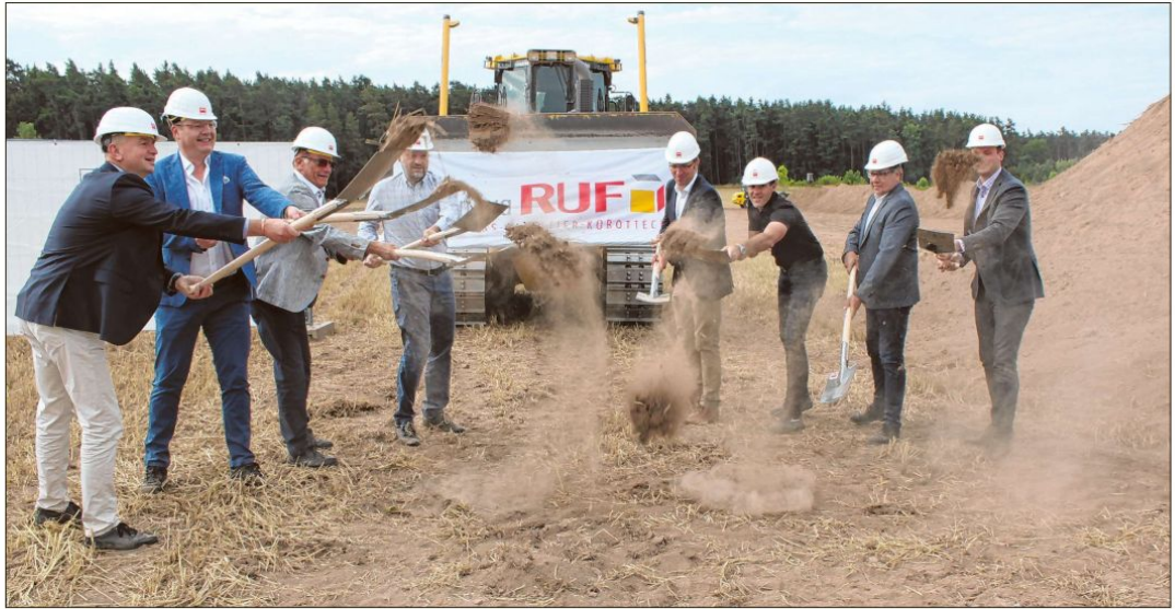
Trocken war's und staubig (von links): Oberbürgermeister Thomas Deffner, Michael Ruf, Dr. Klaus-Peter Ruf, Martin Ruf, Wirtschaftsförderer Christoph Albrecht sowie Walter Gradi, Jürgen Dietrich und Sebastian Marquart (alle drei von der Köster GmbH, der beauftragten Baufirma) beim Spatenstich in Brodswinden für das neue Werk II von Transnova Ruf. Foto: Sebastian Haberl
